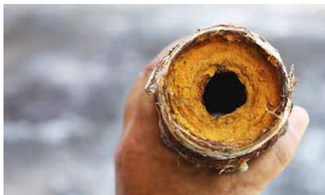
Odpadní potrubí je často zanesené tak, že ztratí až polovinu průměru
